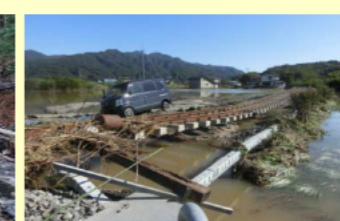
路盤・道床流出（津軽石～弘川）
