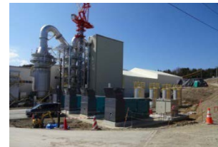
葛尾村の仮設焼却施設 (平成27年4月)
