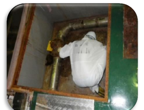
トラブル状況確認
