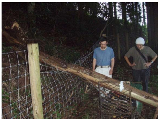
倒木により破損した金網柵
