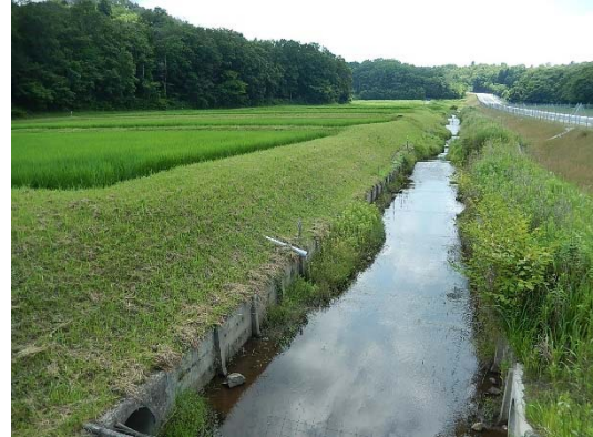
草刈り対策後の様子
