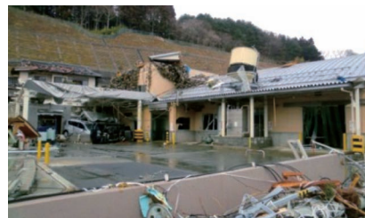
被災した施設
