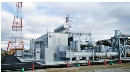
福島送電（株）都路変電所【田村市】
