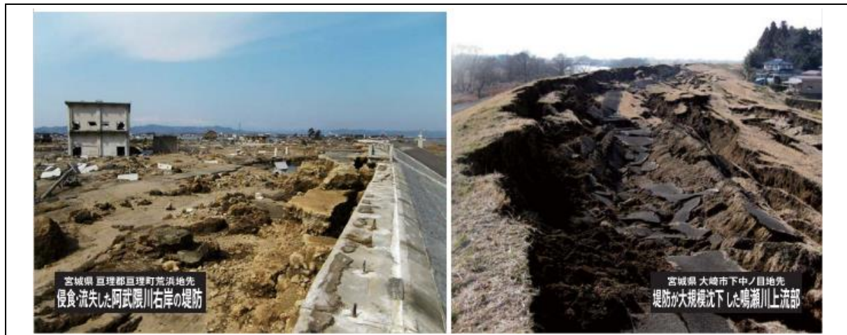
図表 5-6-4 河川堤防の損壊例
